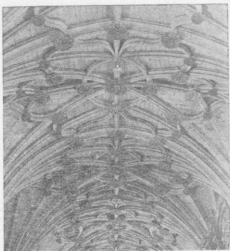
Bóvedas góticas de la iglesia. Las nervaduras tienen delicadas molduras y se entretienen de forma complicada y armoniosa
